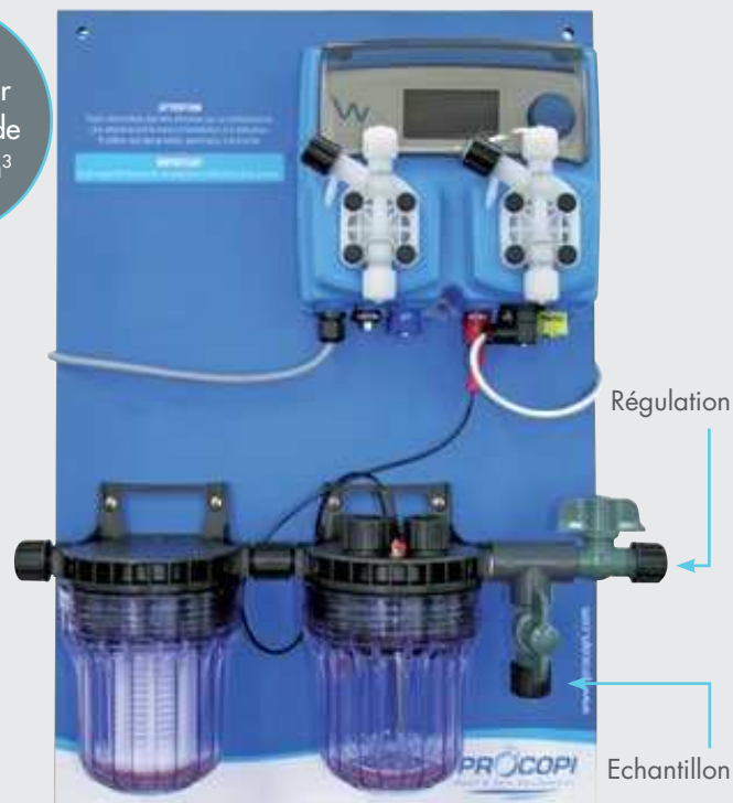
Le Regul System EMEC-E est livré complet, pré-monté et pré-câblé sur une plaque en bakélite.
